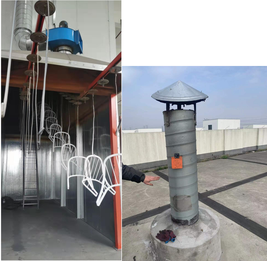
烘道固化废气、天然气燃烧废气处理设备照片
