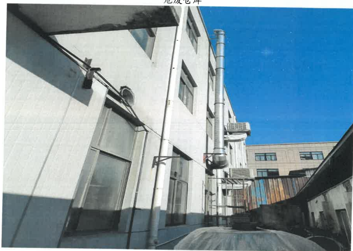
注塑废气收集排放排气筒
