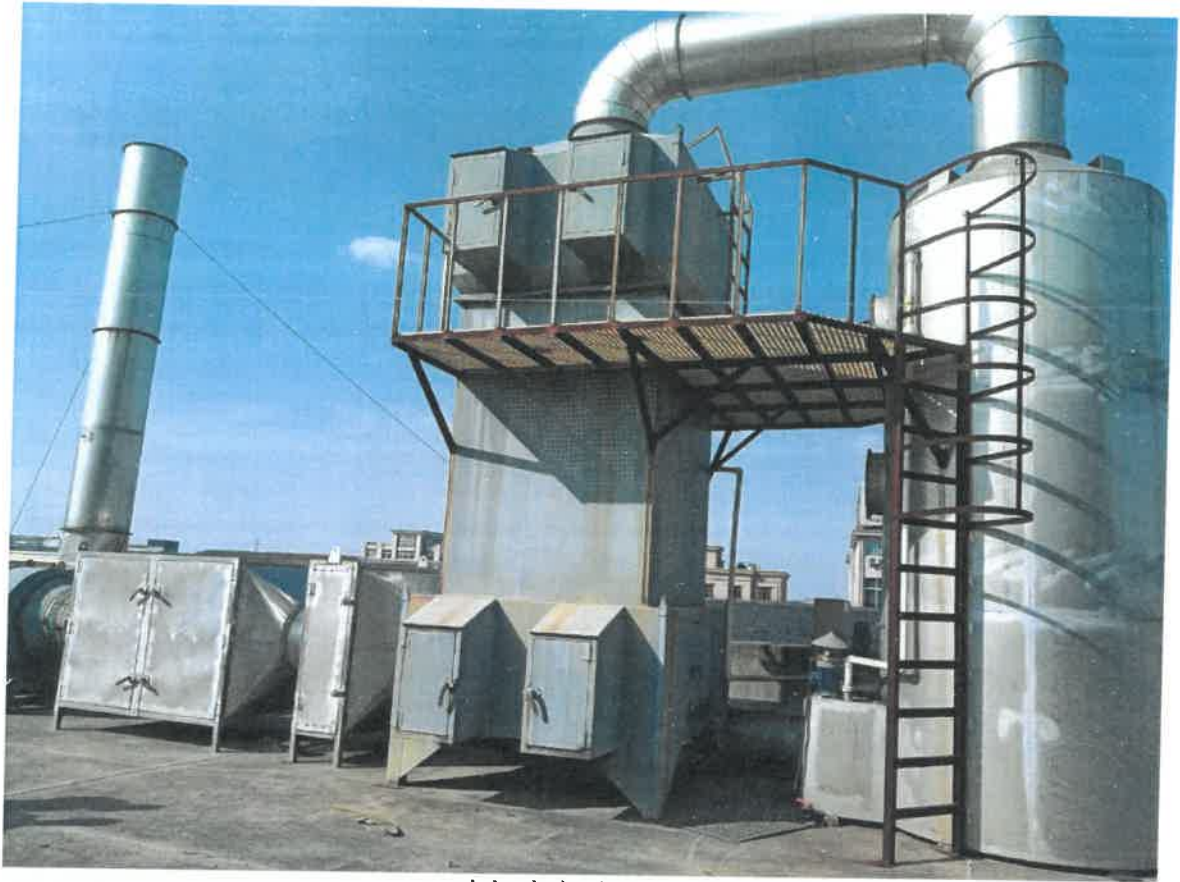
造粒废气处理设施
